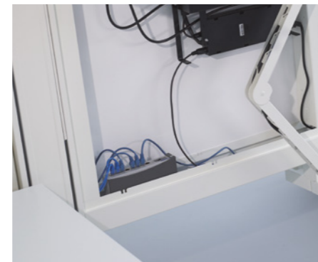
Router geplaatst in systeemwand
