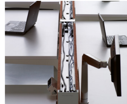
Bekabeling door Centrale kabelgoot
