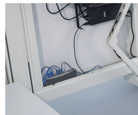
Router geplaatst in systeemwand
