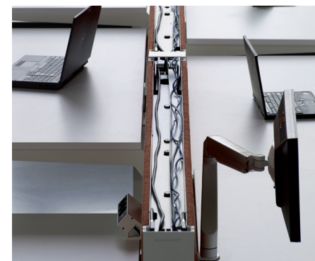
Bekabeling door Centrale kabelgoot
